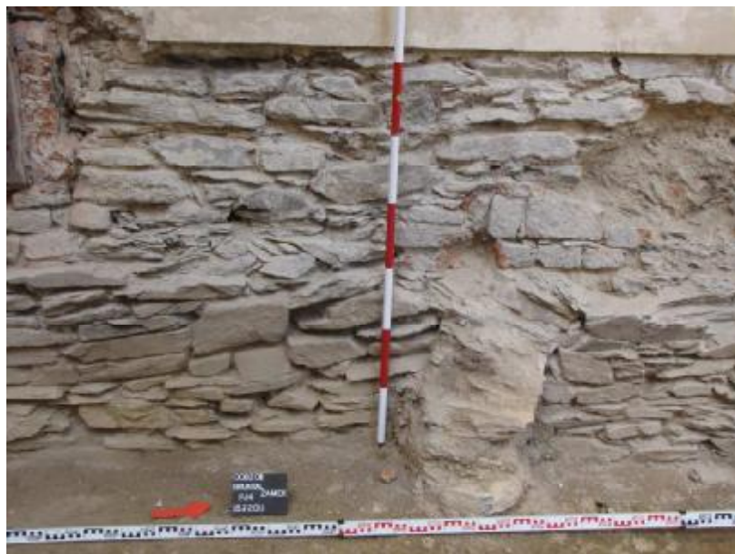
Obnažené zdivo v JZ části zámku, vpravo rozpoznáný klenební pas, zřejmě indikující předchozí hradní zástavbu
