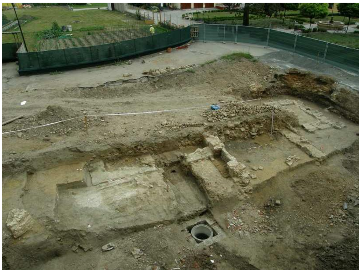
Celkový pohled od severozápadu na skrytou archeologickou situaci v místě úpravy vstupu do lapidária.
